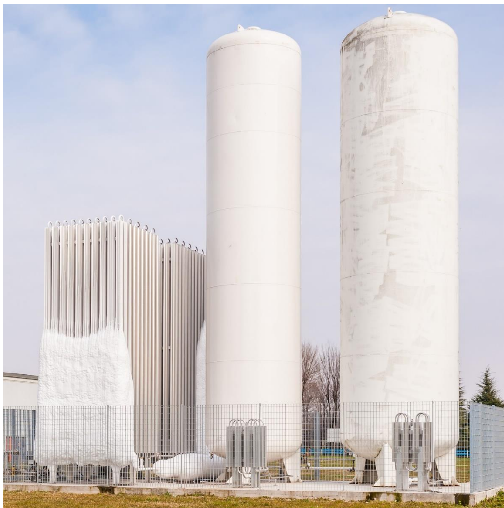
Foto nr. 19: Cryogene tanks.
